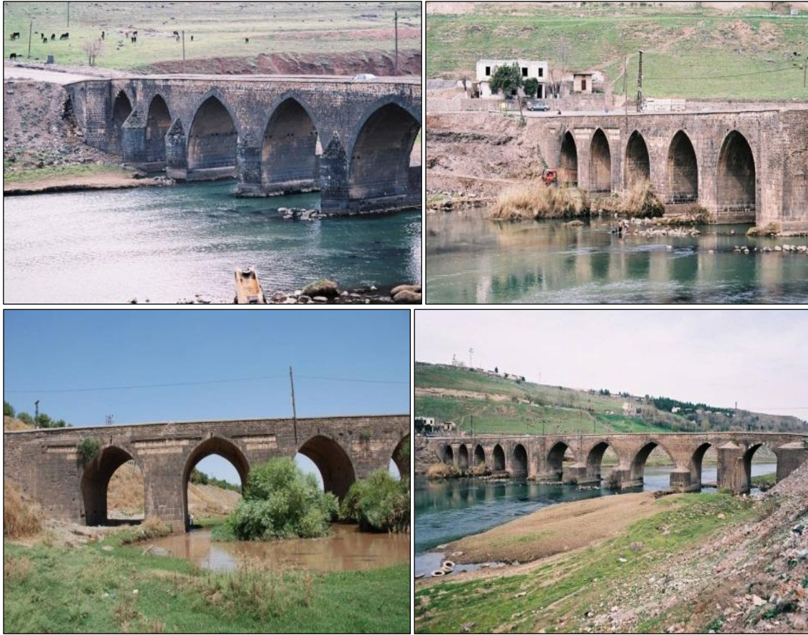
Şekil 5. Restorasyon öncesinde köprünün durumu ve etrafı (Karayolları, 2007 Arşivi)
